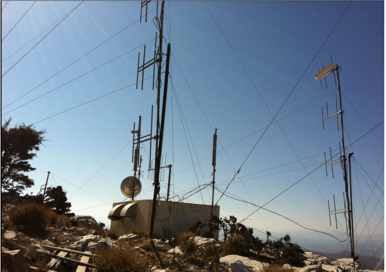
Σχήμα 44. Παράδειγμα: φωτογραφία ιστού/ εγκατάστασης με λεπτομέρειες του κεραιοσυστήματος
